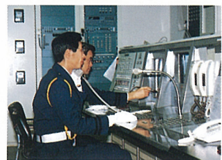
管理防災センター
